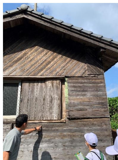
▲唐見崎にある弘法様のお堂の壁には、当時、港に停泊していた海軍の船体に張られていた板材が使われています。当時の塗料の緑色が今でも残っているところがあります。
